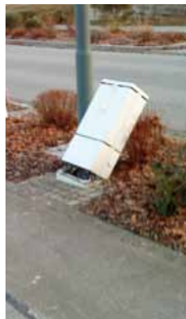
Die so genannte „elektresch Käsch“ gegenüber dem Friedhof wurde beschädigt.
