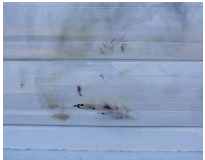
Die Rolläden des Postbüros, ebenfalls Eigentum der Gemeinde, wurden durch Verbrennungen zerstört.
